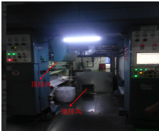
有机废气集气装置
