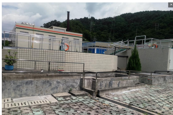
项目废水处理设施
