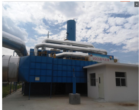
有机废气处理设施
